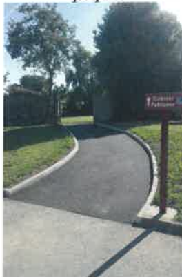
Création d'un chemin entre le parking de la mairie et la rue de Guerlogoden
